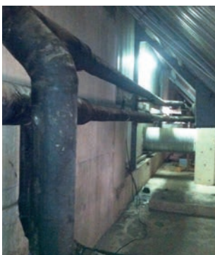
toile bitumineuse amiantée sur canalisation
