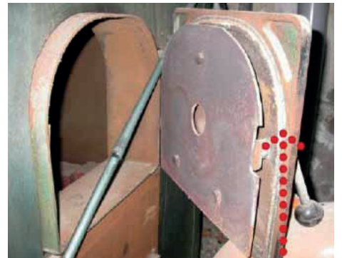
Joints de chaudière
